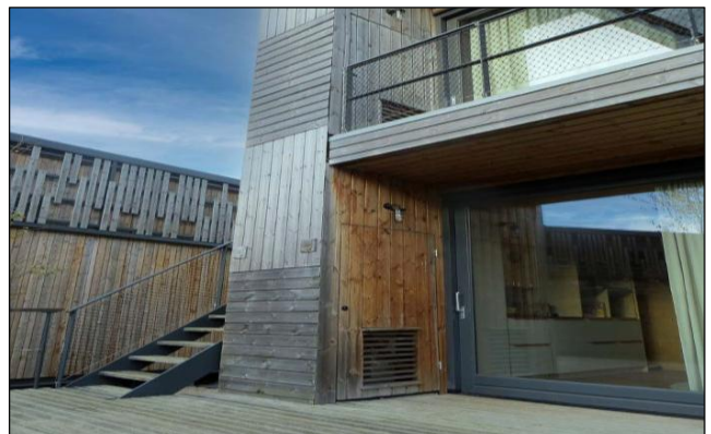
Año de construcción 2020, foto 2022, Países Bajos. El punto de la brújula también afecta el progreso del proceso de envejecimiento. El color a veces puede ser parcial o totalmente negro. Las condiciones de humedad momentáneas también afectan el tono predominante de las tonalidades. La dirección de instalación también afecta la velocidad del proceso.
