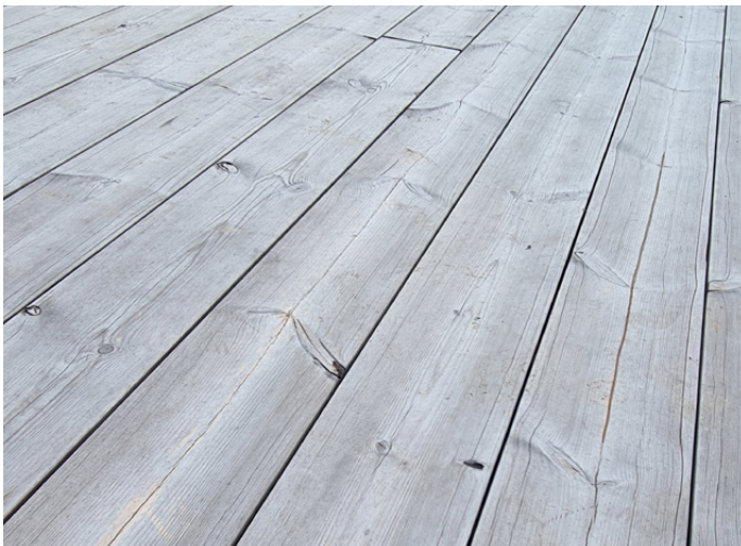
Pintakäsittelemätön Lunawood-terassi kaksi vuotta asentamisen jälkeen. UV-säteily on aiheuttanut pieniä, puulle ominaisia hiushalkeamia terassin pinnalle.
