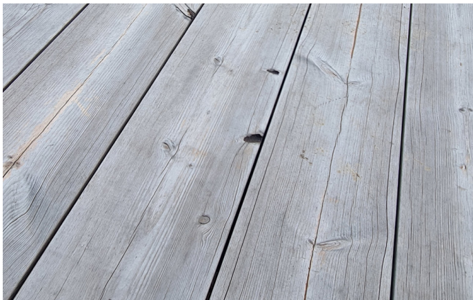
Käsittelemätön Lunawood-terassi 2 vuotta asennuksen jälkeen. Pinnassa näkyy hienoja hiushalkeamia
