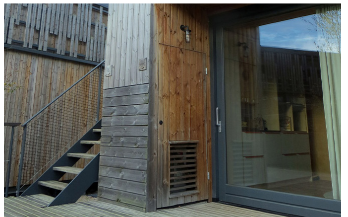
Fassadenverkleidung in den Niederlanden zwei Jahre nach der Installation. Die Ausrichtung des Gebäudes beeinflusst den Verlauf des Vergrauungsprozesses. Die Farbe kann teilweise oder vollständig schwarz erscheinen. Auch die Feuchtigkeitsbedingungen können den vorherrschenden Farbton beeinflussen.
