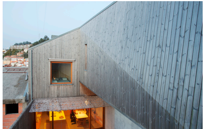
Fassadenverkleidung in Portugal 4 Jahre nach der Installation. Die Oberfläche hat einen schönen silbergrauen Farbton angenommen. ©Tiago Casanova
