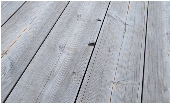
Unbehandelte Lunawood-Terrassendielen 2 Jahre nach der Installation. Auf der Oberfläche sind feine Haarrisse sichtbar.
